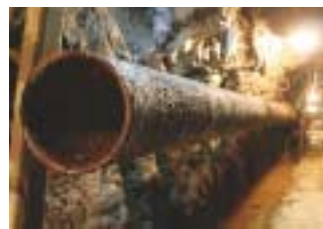
坑道内に張り巡らされたパイプは、圧縮空気を通して機械を動かしたり、換気利用された。
