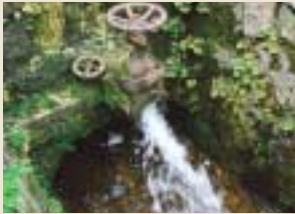
水路に取り付けられているバルブ。台風時などには閉められ、水量を調節している。
