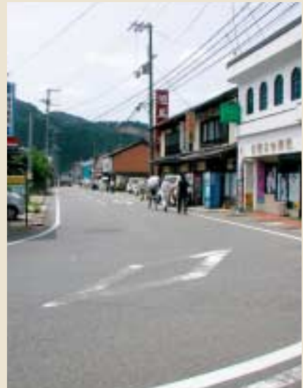
4間道路(道幅約7.2m)のクラック
