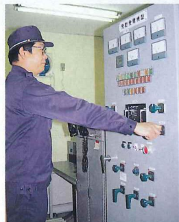
コンピューター制御ですべて行われている。何かあっても事務所へ連絡がすぐはいる。
