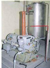
停電になっても大丈夫。発電装置が完備されている。
