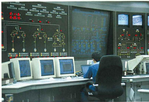
無人の発電所をコントロールする心臓部、コンピュータールーム。
