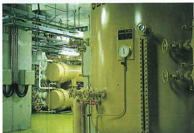
地中深くに広がる大規模な発電施設。空洞は高さ47mで、ほぼ12階建てのビルの高さに相当する。
