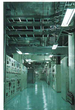
どこまでも続く地下空間。かつてこの場所です約100万人もの人々が難工事に挑戦した。わが国最大規模の5-6号機と発電機用遮断機が見学できる。
