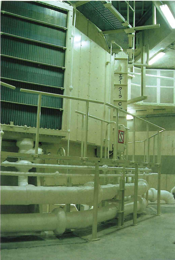
巨大な電力を生み出している発電機。
