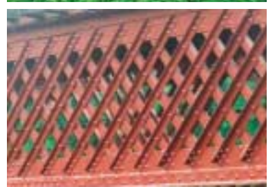
1連だけ残ったラチス桁。力学的計算に基づいた設計になっている。橋梁までは敷設路が整備されている。
