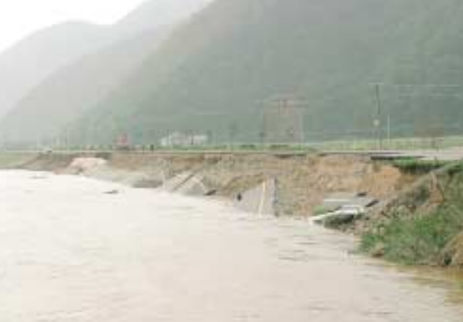
台風23号により道路が陥没した国道426号(豊岡市出石町寺坂)
