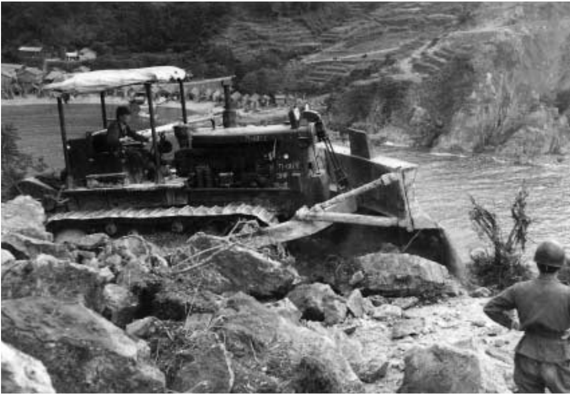
ブルドーザーによる掘削作業。すぐ先は奈落の底、断崖が迫る。(西一氏蔵)
