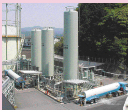
天然ガス供給製造プラント
